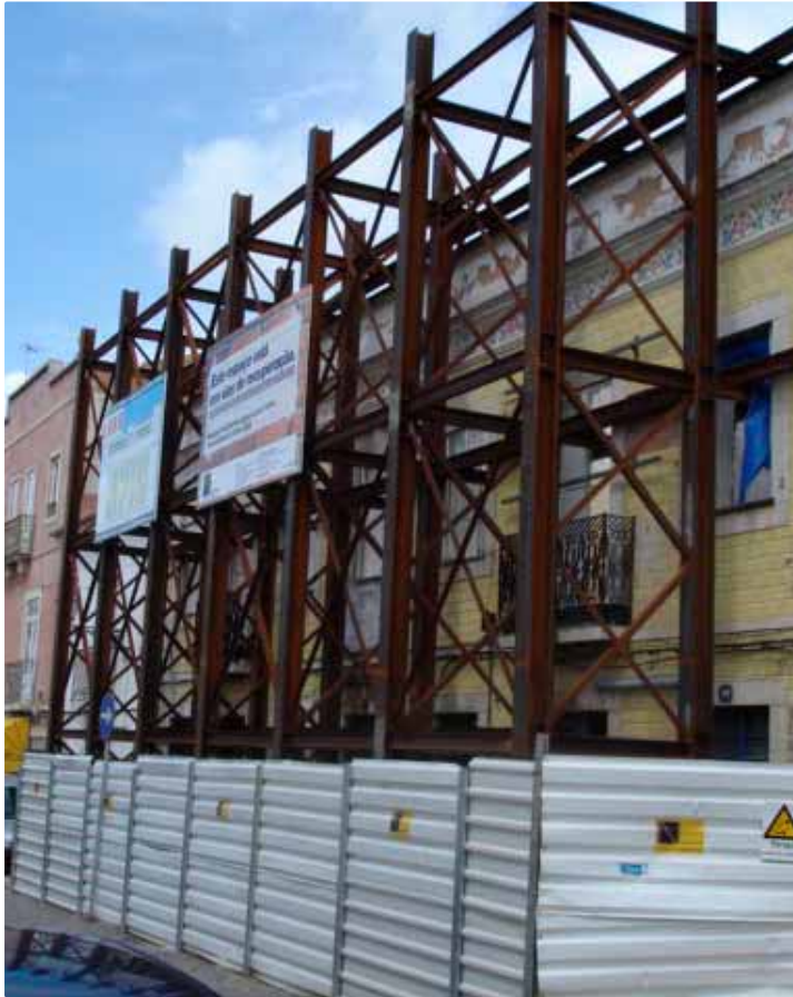
Demolição e Reconstrução de edifício na Rua 25 Abril, Lagos, Algarve Demolition and Reconstruction of Building located in Rua 25 Abril, Lagos, Algarve
